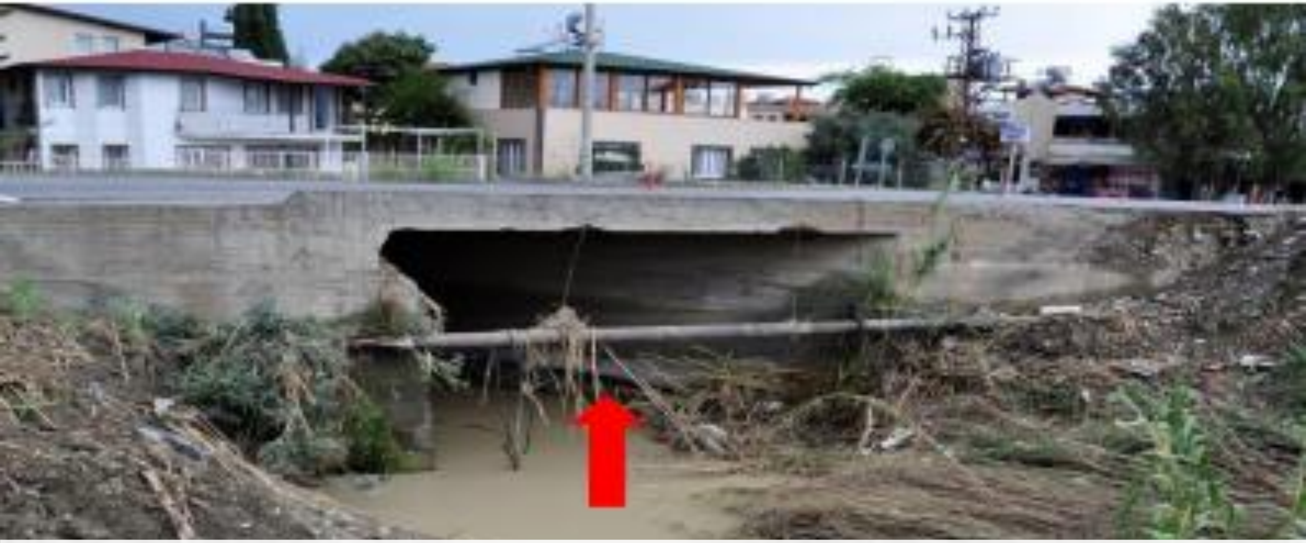
Kesiti daraltan içme suyu borusu
