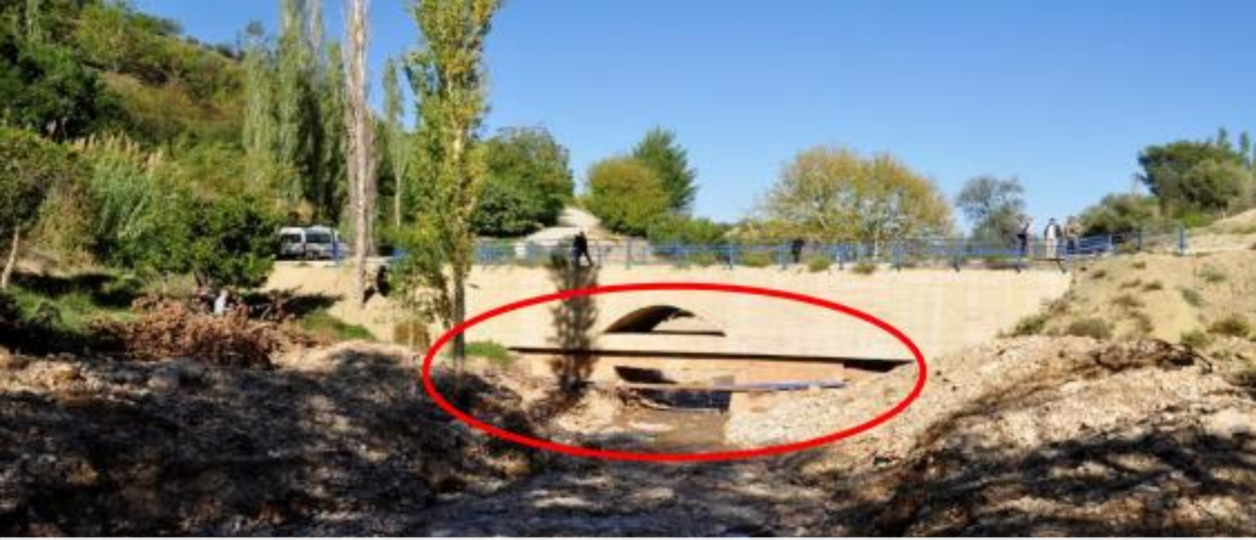
Tekniğe aykırı köprü
