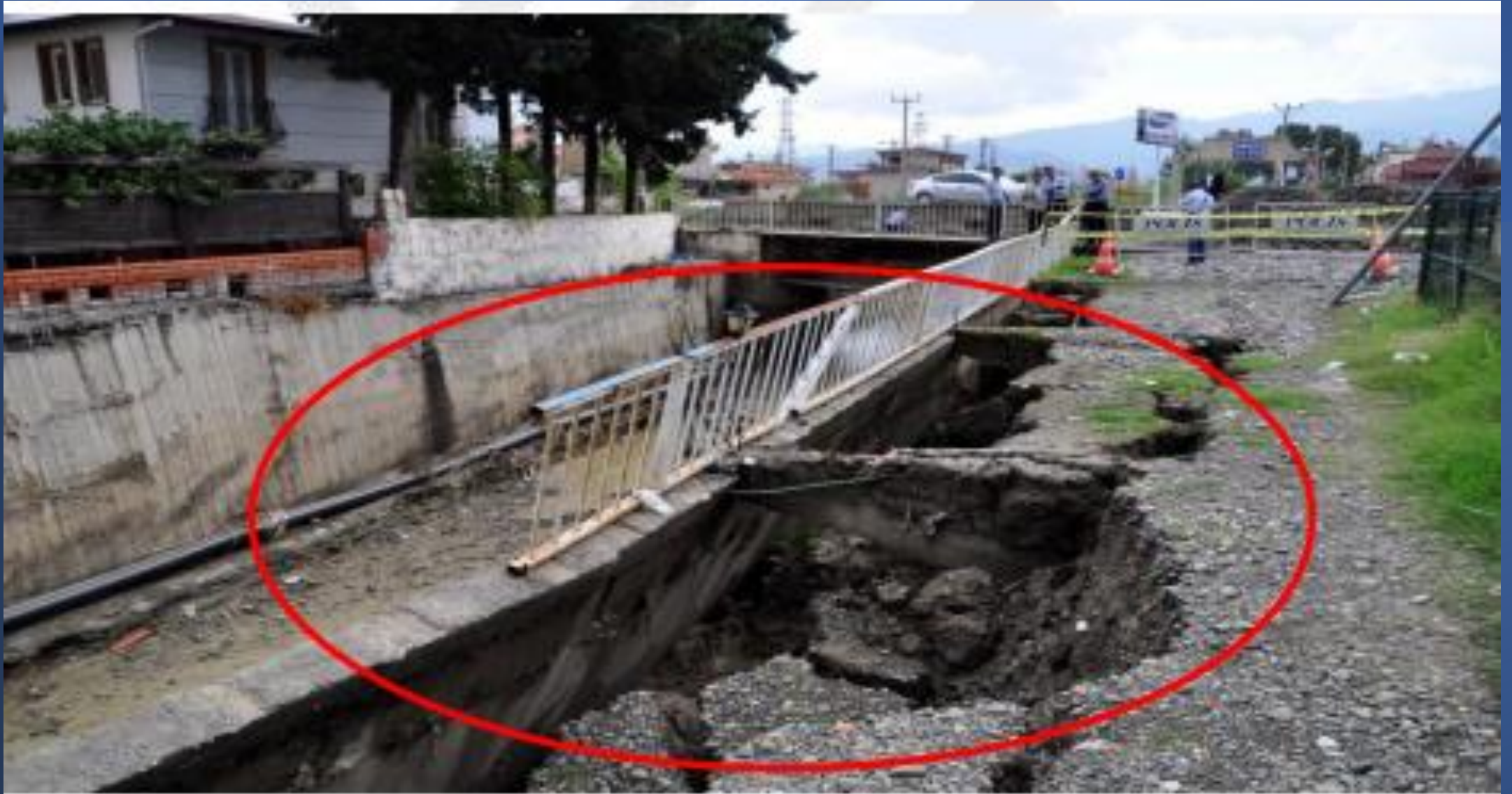
Resim 4.39. Arsuz ilçesi Sođanlık Deresi boyunca taşkın sonrasında meydana gelen hasar
