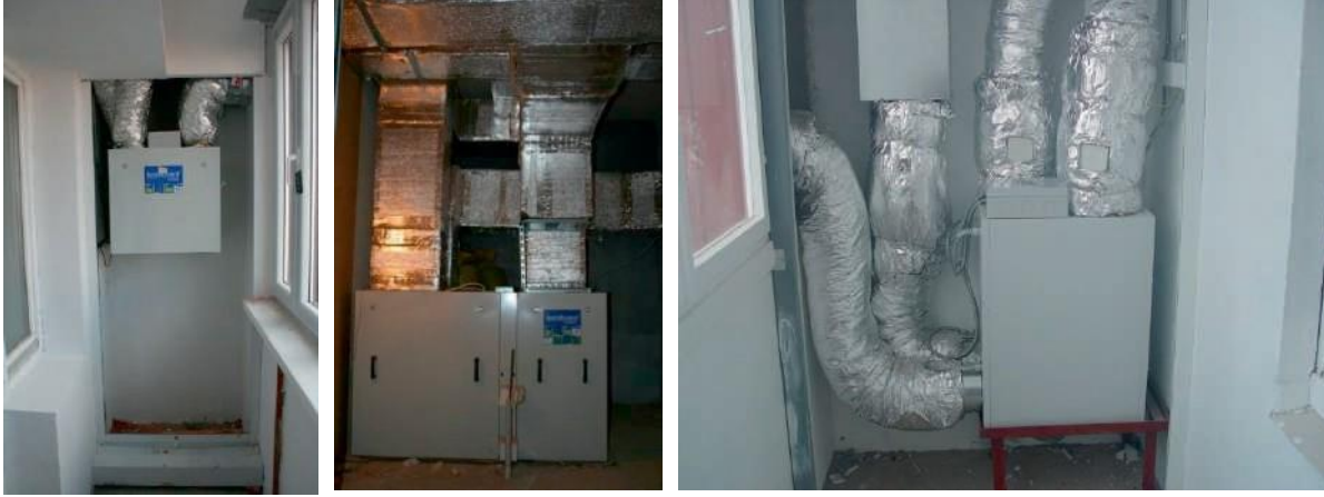
Şekil 13. Mekanik giriş ve çıkış havalandırması için ısı geri kazanım ünitesi
