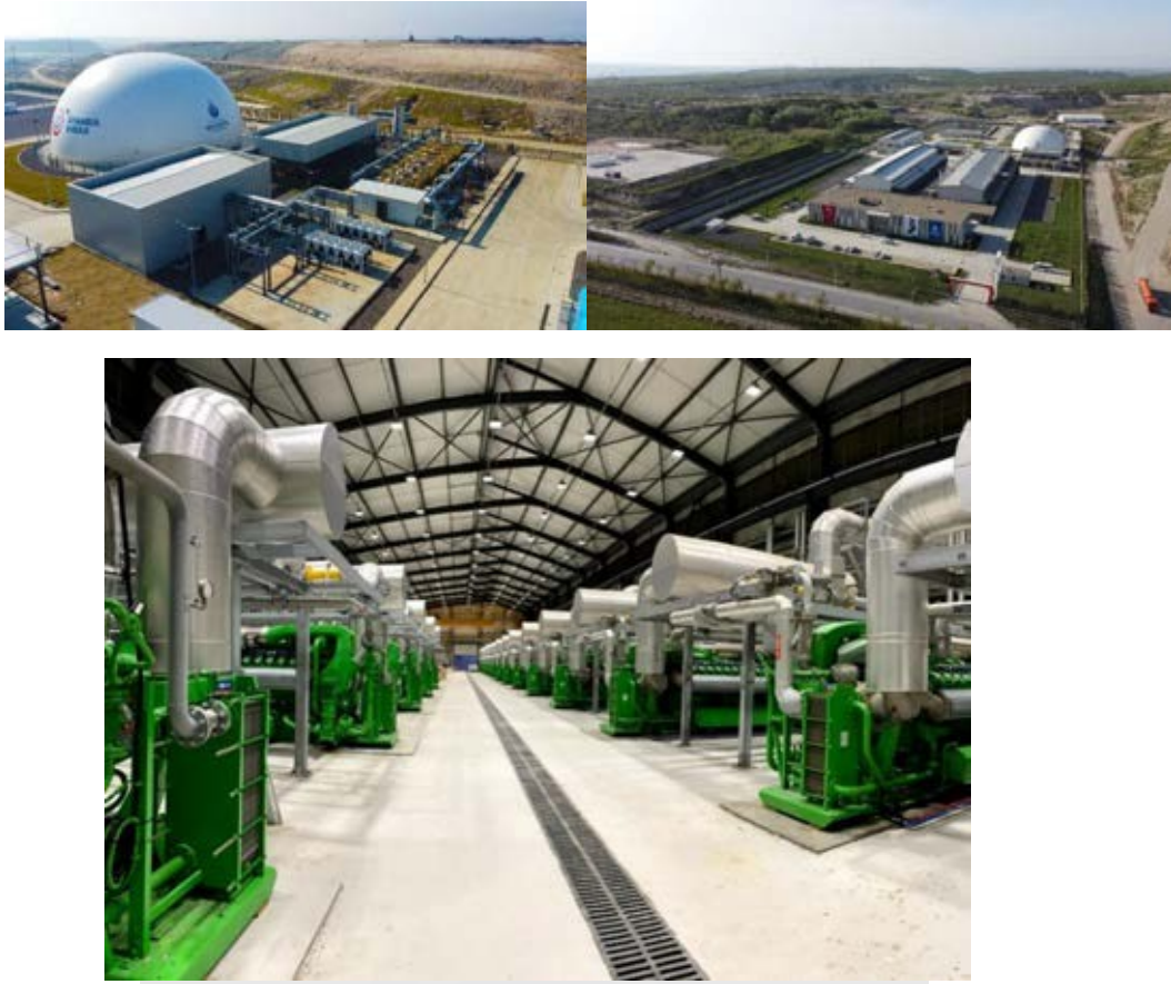
İstanbul Enerji A.Ş. Silivri Seymen Biyokütle Enerji Santrali
