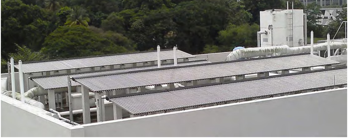
Şekil 4.12.5: Bina çatısına kurulan güneş enerjisi sistemi
