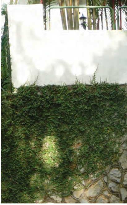
Duvar yüzeylerinde sürünenler
