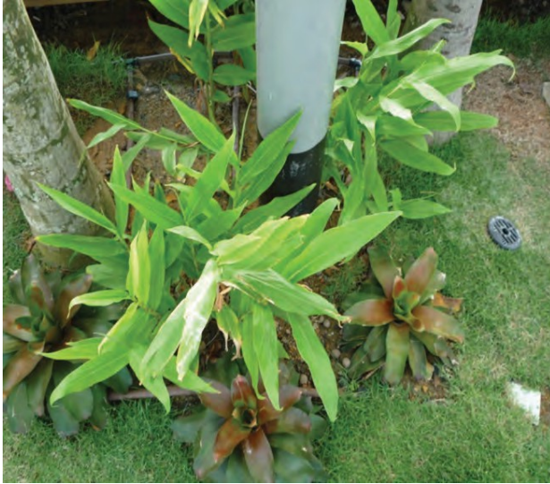
Şekil 4.9.6: Bir damla sulama sistemi
